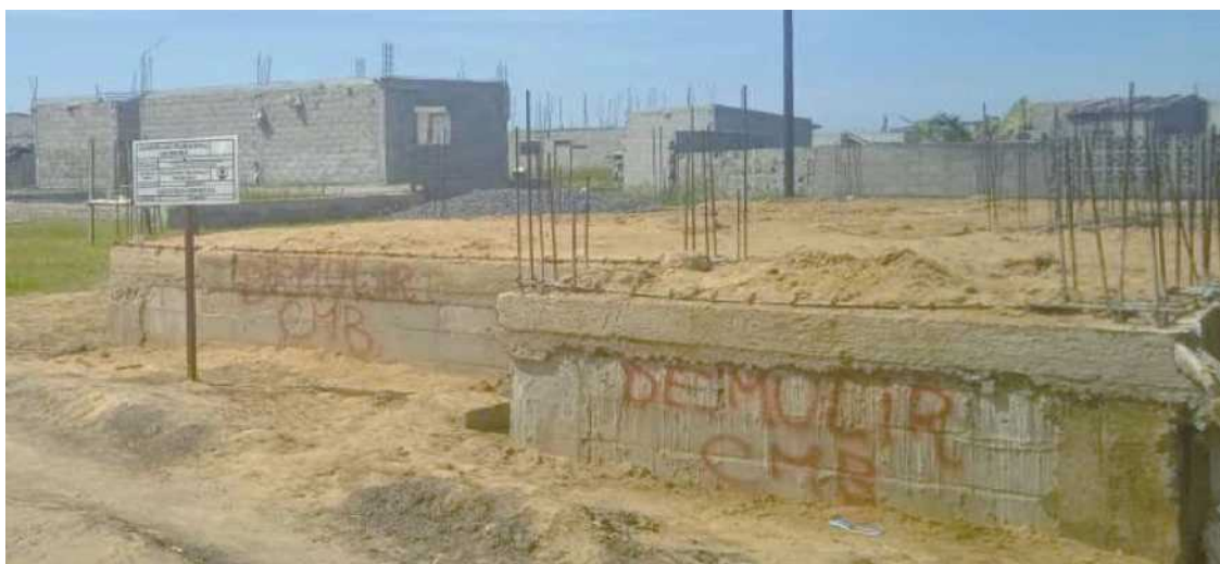
Fotografia 3. Estrutura prevista para demolição, datada de 28 de Fevereiro de 2025, mostrando as fundações construídas pelo Requerente n.º 1 dentro do corredor de impacto do Projecto. As marcações municipais indicam claramente que a estrutura deve ser demolida. A licença de construção exibida no lado esquerdo corresponde à licença emitida para um imóvel diferente em Macurungo (o qual não é afectado pelo Projecto).
