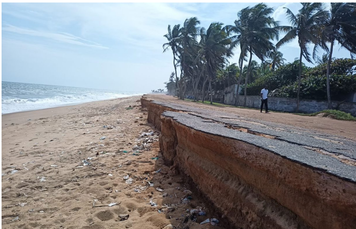
Photo 2. Des restes de la deuxième route érodée reliant Lomé à Aného
