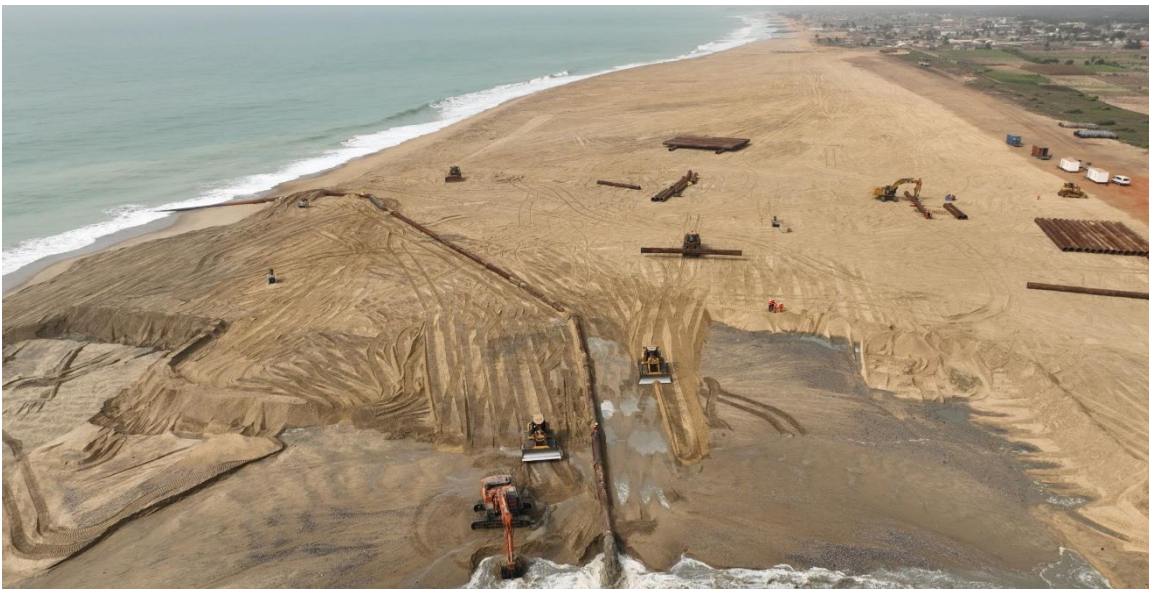
Photo 4. Restauration des plages par pompage de sable sur le littoral au Bénin, qui fait partie de la solution de protection des zones côtières du Togo et du Bénin (mars 2023)
